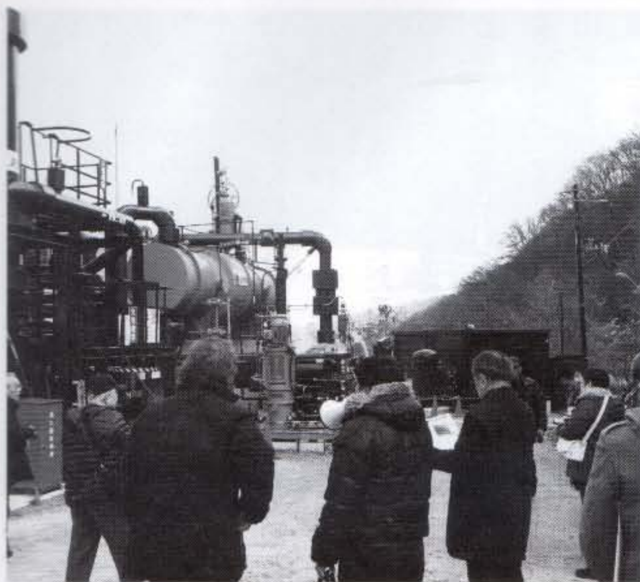
土湯の地熱発電所
